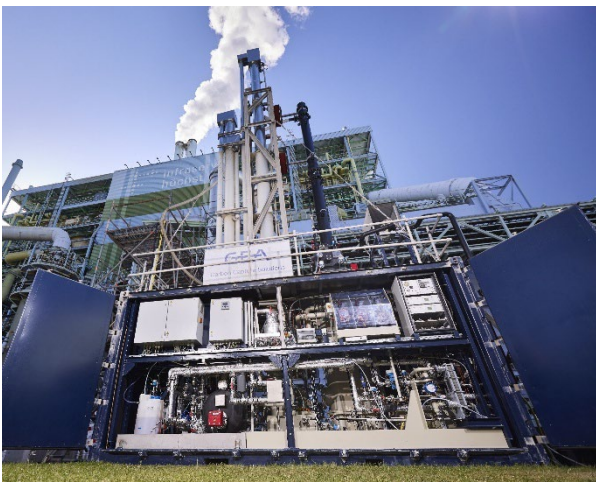
Pilotanlage der GEA-Group zur CO 2 -Abtrennung am Standort Industriepark Höchst. Quelle/Copyright: Dominik Burschardt, Nutzungsrechte: InfraserV Höchst
